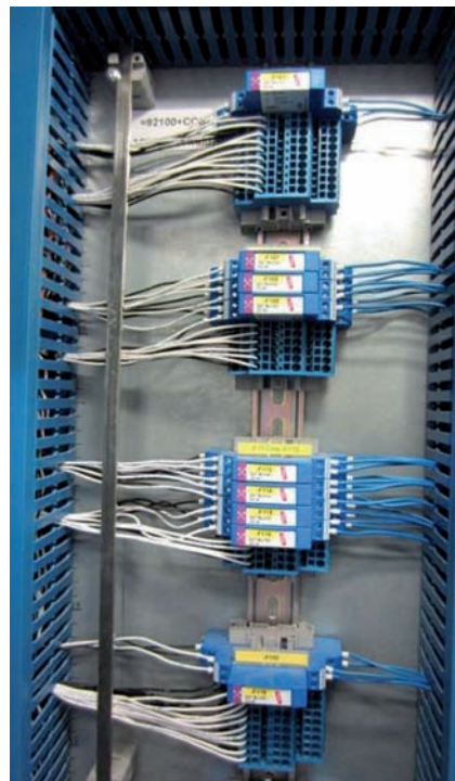
Zariadenie BLITZDUCTOR vo vyhotovení Exi nainštalované do iskrovo bezpečných obvodov MaR
