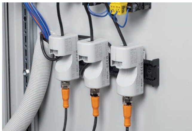
Meranie prúdu pomocou ESS 076 v trojfázovej elektrickej sieti
